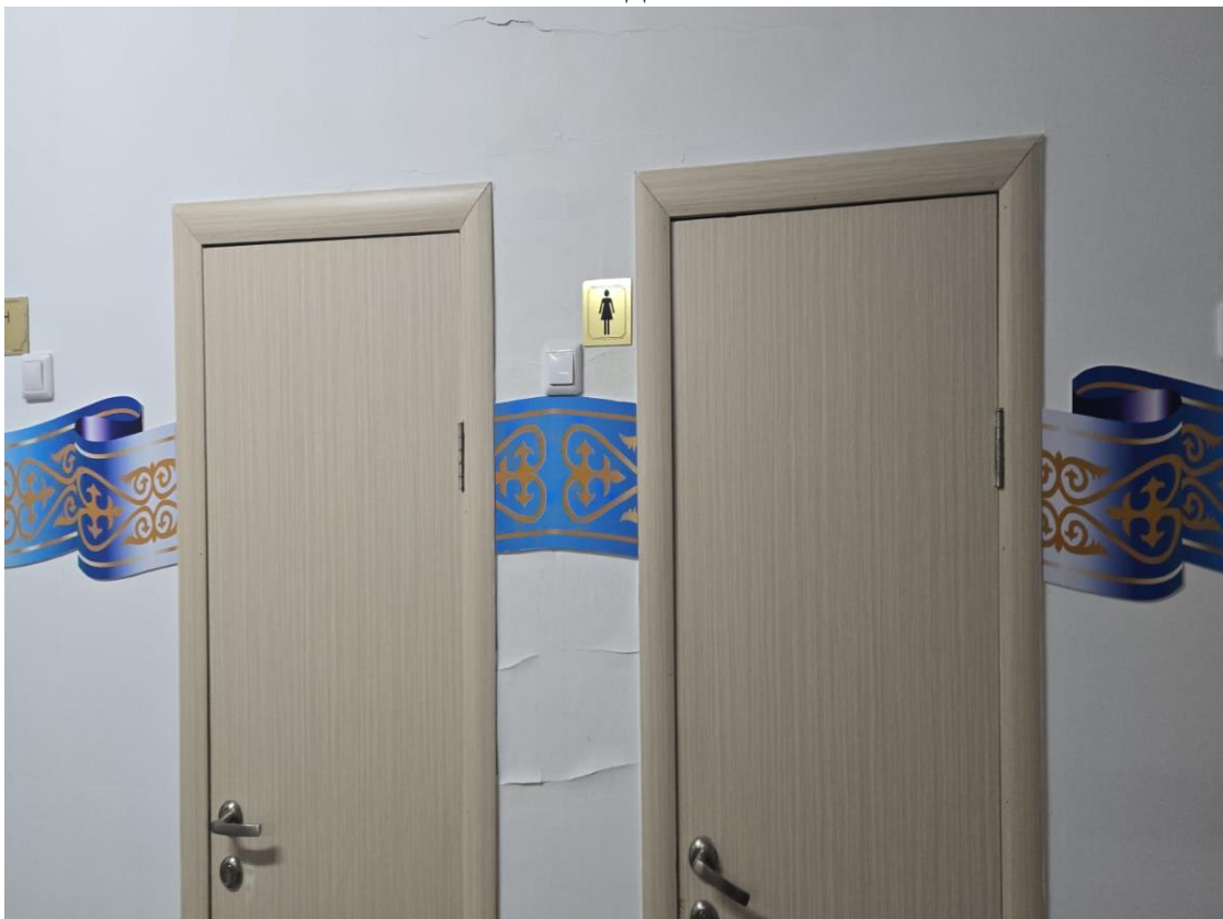
Рисунок 18. Состояние дверей дверных проемов
