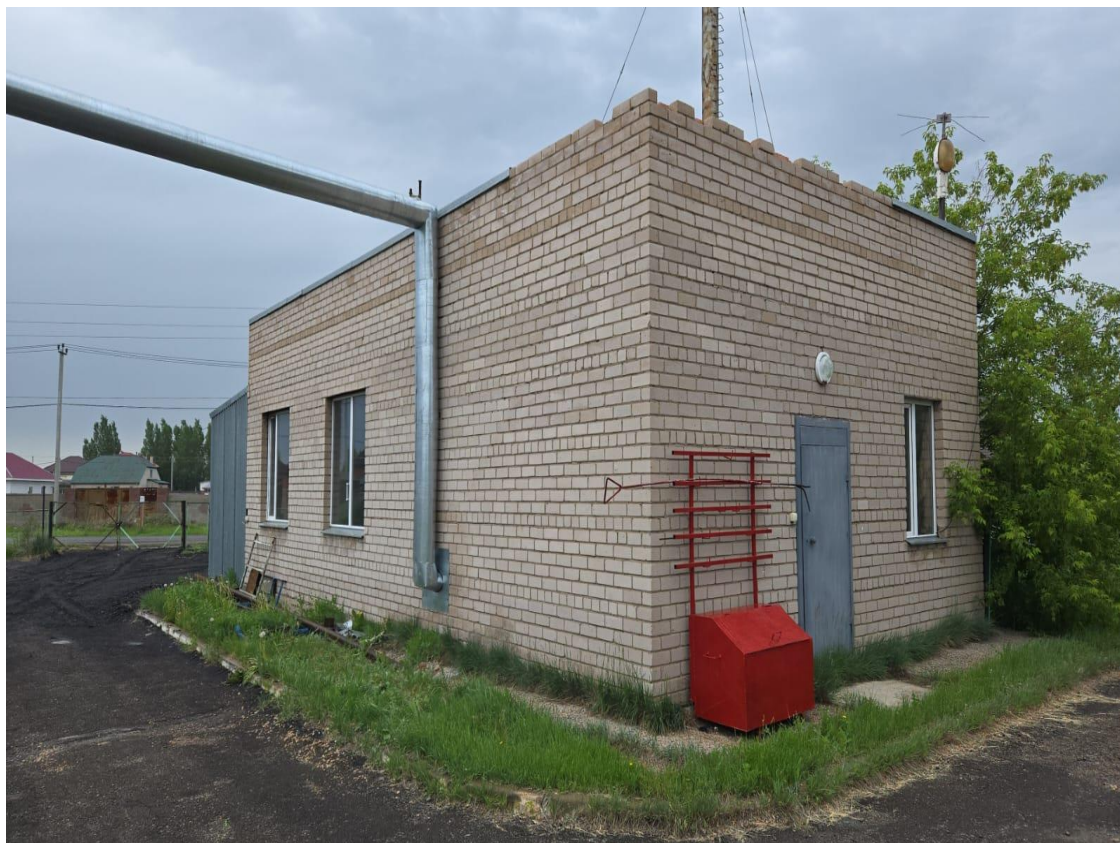
Рисунок 13. Состояние внешней отделки
