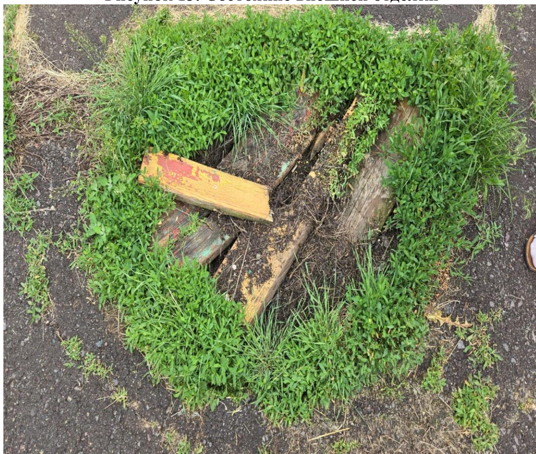
Рисунок 14. Состояние канализационных люков
