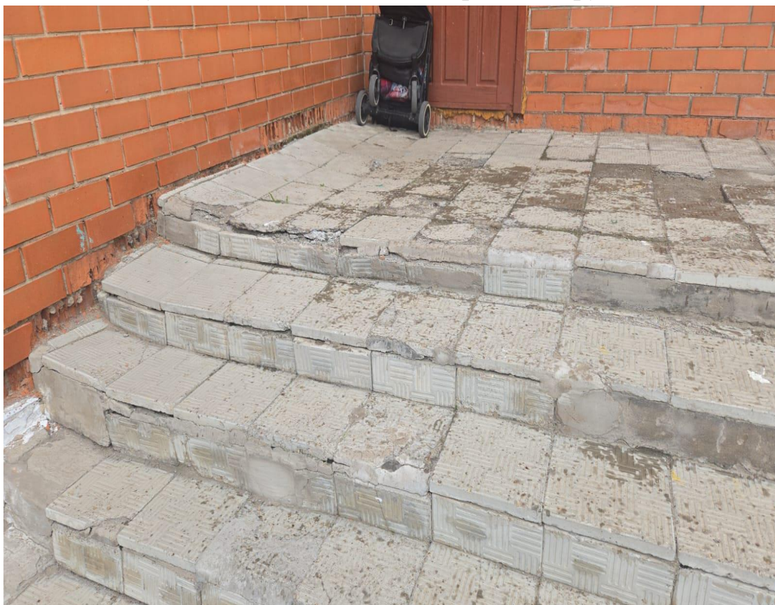
Рисунок 38. Состояние входной группы
