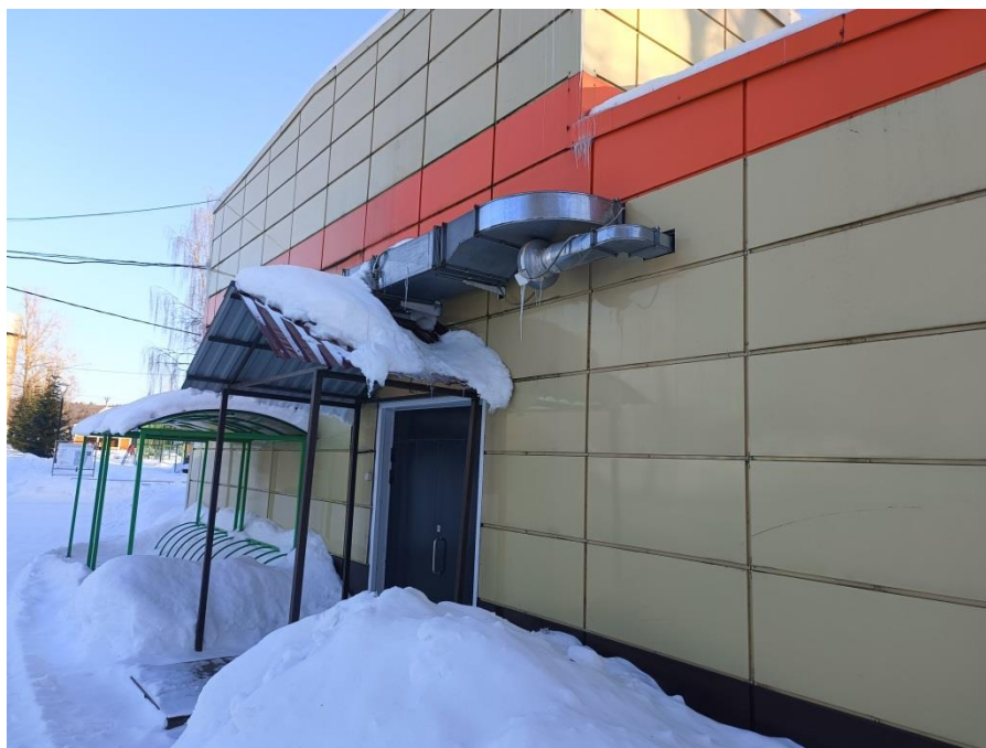
Фото №64. Вытяжные вентиляторы на фасаде здания.
