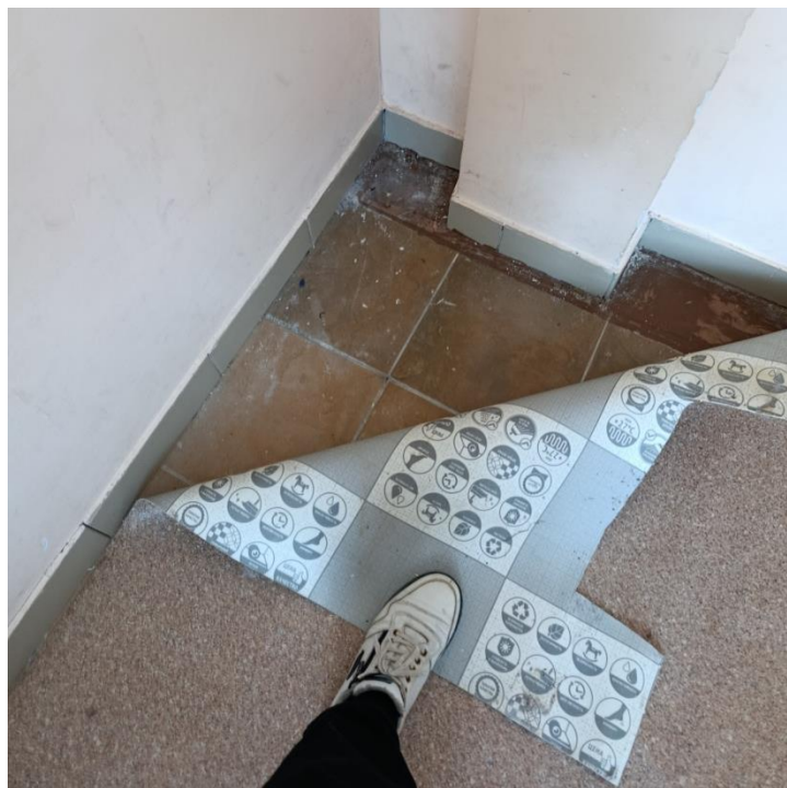
Фото 28. Линолеум уложен поверх керамической плитки.
