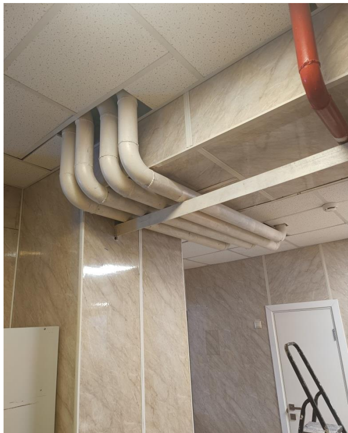
Фото №53. Магистральные трубопроводы отопления от ИТП
