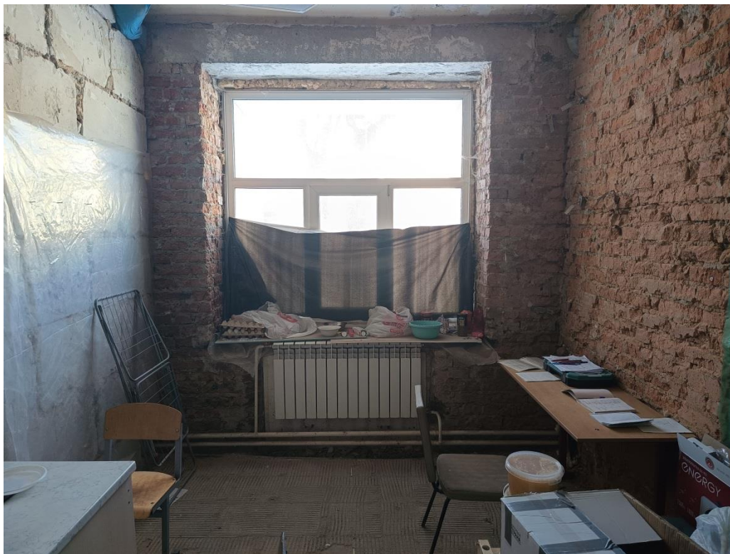
Фото №49. Подключение радиаторов в изоляторе
