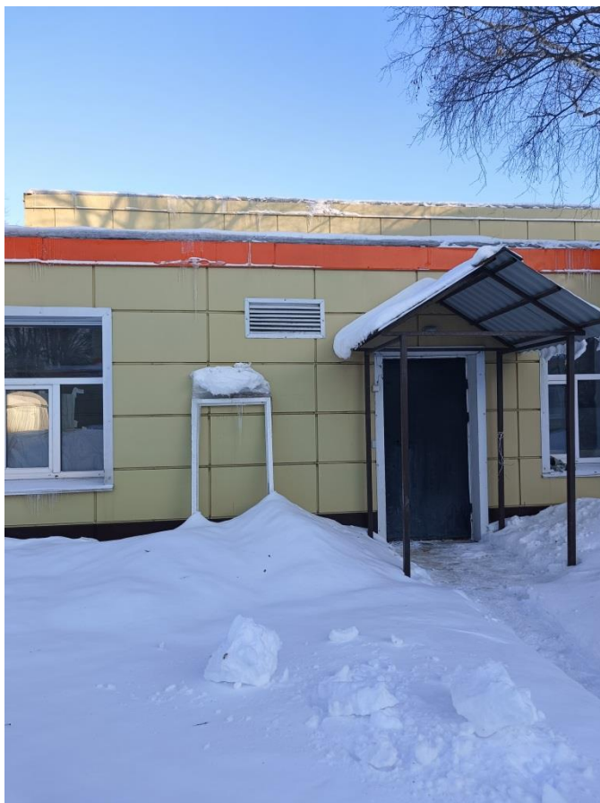
Фото №65. Воздухозаборная решетка на фасаде здания
