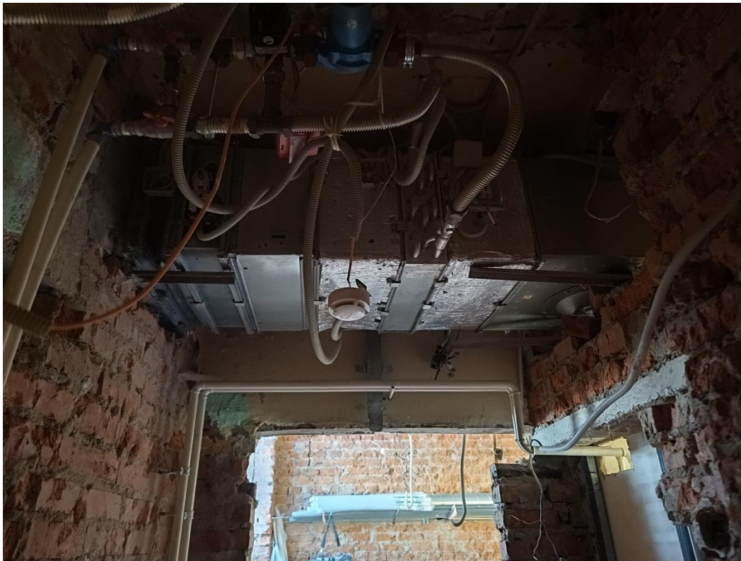
Фото №47. Приточная система в коридоре изолятора
