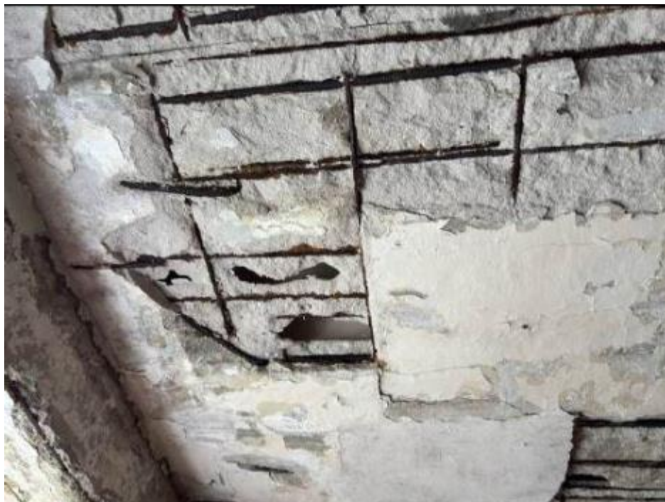
Фото 13. Фрагмент плит покрытия в изоляторе. Разрушение защитного слоя бетона, оголение и коррозия арматуры.
