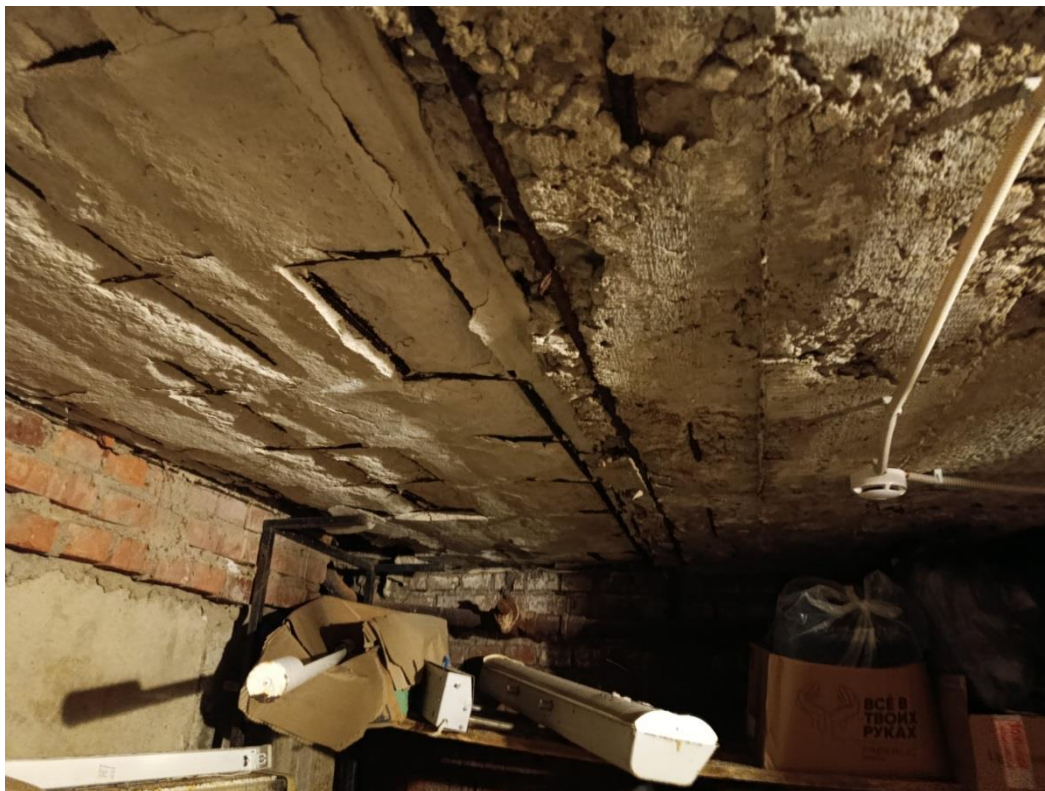
Фото 3. Фрагмент плит перекрытия подвала. Разрушение защитного слоя бетона на нижней поверхности плит перекрытия и как следствие оголение и коррозия арматуры.
