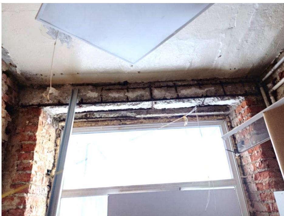
Фото 14. Общий вид надоконных перемычек в осях 11/И-К. Защитный слой арматуры полностью разрушен и как следствие оголение и коррозия арматуры.
