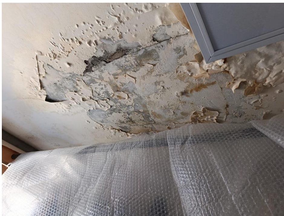
Фото 24. Следы протечек на поверхности плит покрытия. Загрязнение и отшелушивание окрасочного слоя на поверхности потолка.
