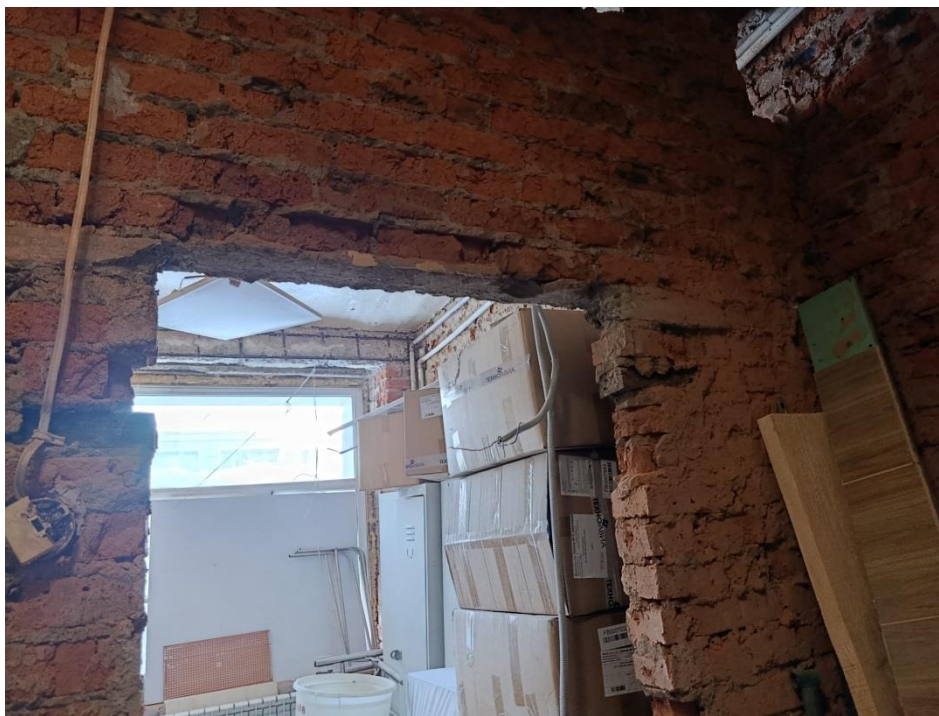
Фото 15. Часть ж.б. перемычке в кирпичной перегородке срезано.
