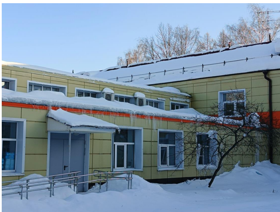
Фото №66. Наружные блоки кондиционеров на фасаде здания
