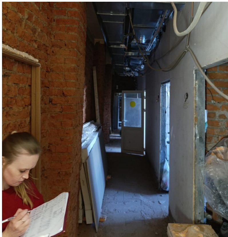
Фото 9. Фрагмент коридора в изоляторе. Отделочные покрытия стен, пола и потолка демонтированы.
