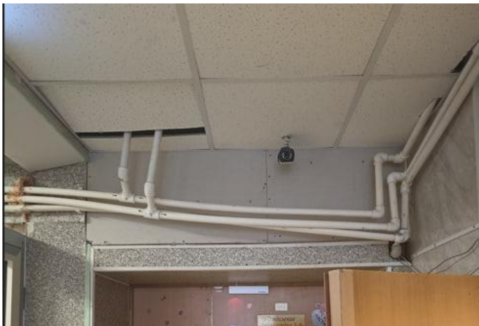
Фото №60. Провисание трубопроводов ГВС в коридоре
