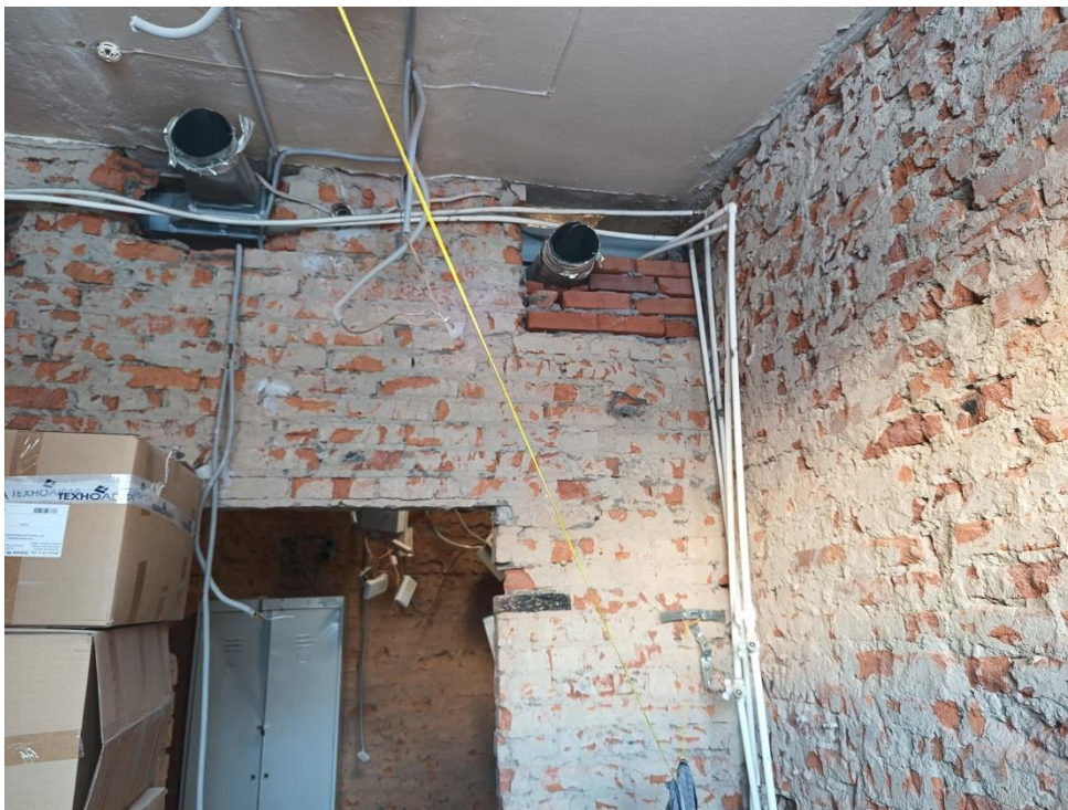
Фото №59. Трубопроводы водоснабжения в блоке изолятора
