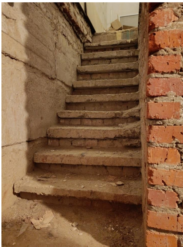
Фото 2. Лестница спуска в подвал. Перекосы, сколы бетонных ступеней.
