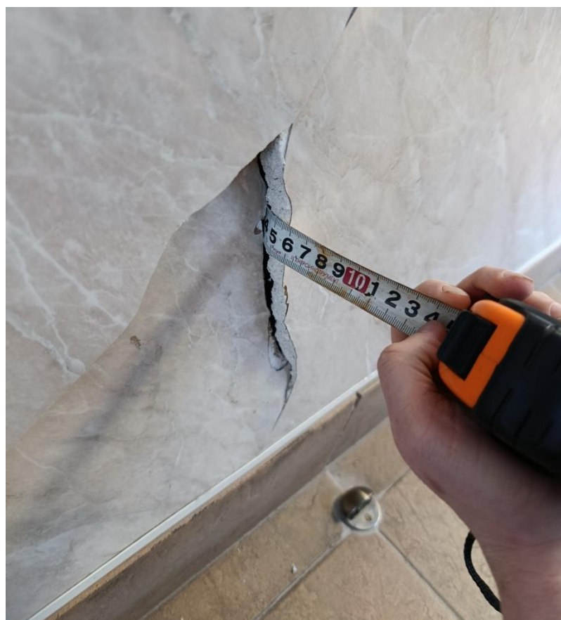
Фото 8. Пробоина обшивки из ламинированных листов ГКЛ по мет. каркасу в коридоре здания.
