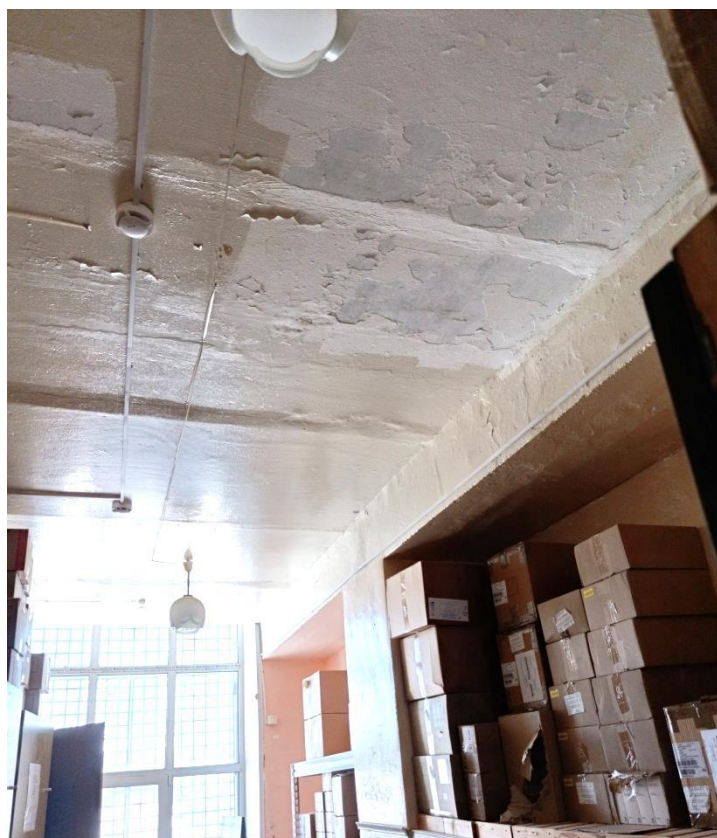
Фото 20. Фрагмент плит покрытия в осях 13-15/И-К. Следы протечек на поверхности потолка, отшелушивание окрасочного слоя.
