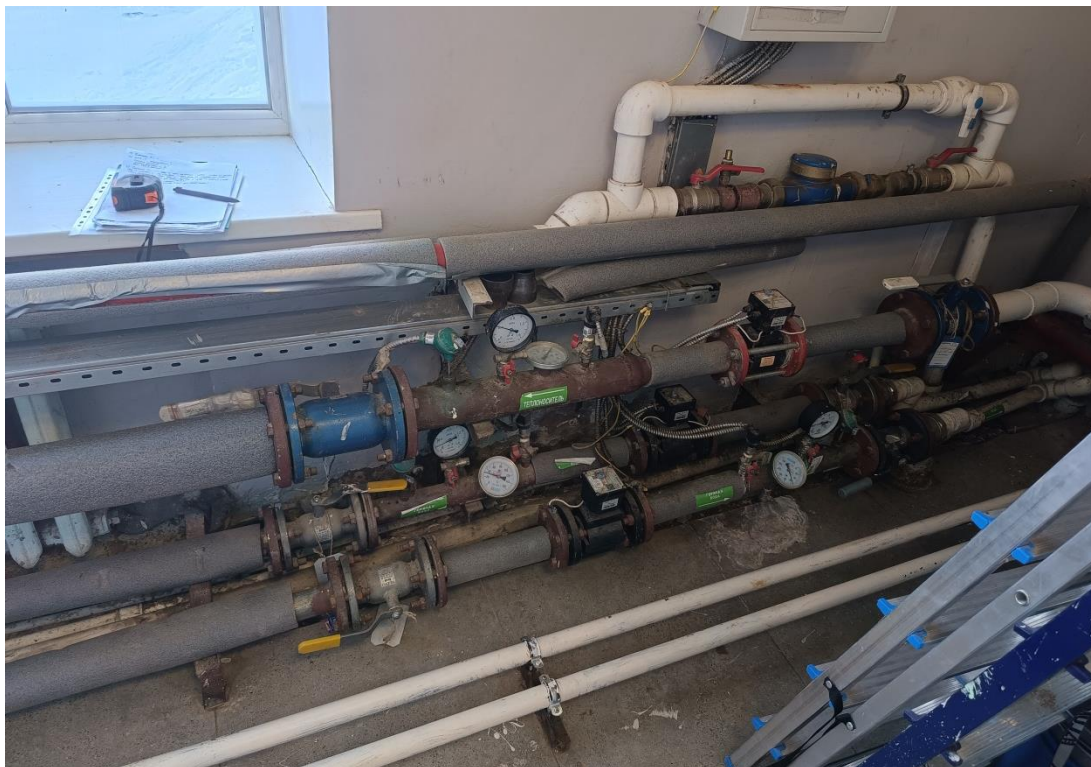
Фото №57. Узел ввода (ИТП)
