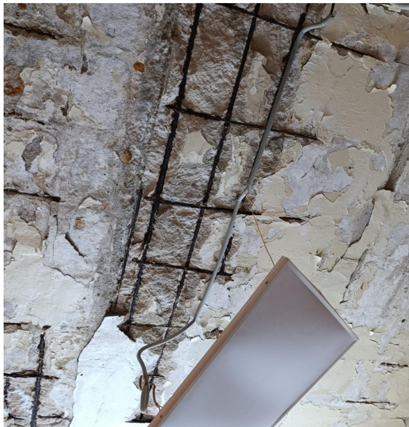
Фото 11. Фрагмент плит покрытия в изоляторе. Разрушение защитного слоя бетона, оголение и коррозия арматуры.
