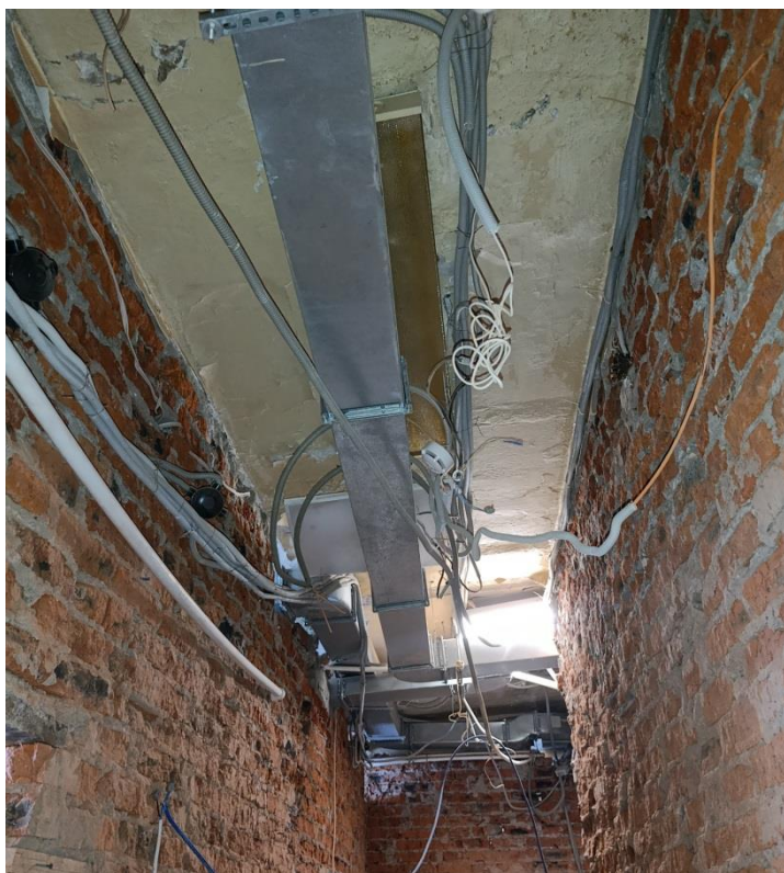
Фото 16. Общий вид инженерных сетей в коридоре изолятора.
