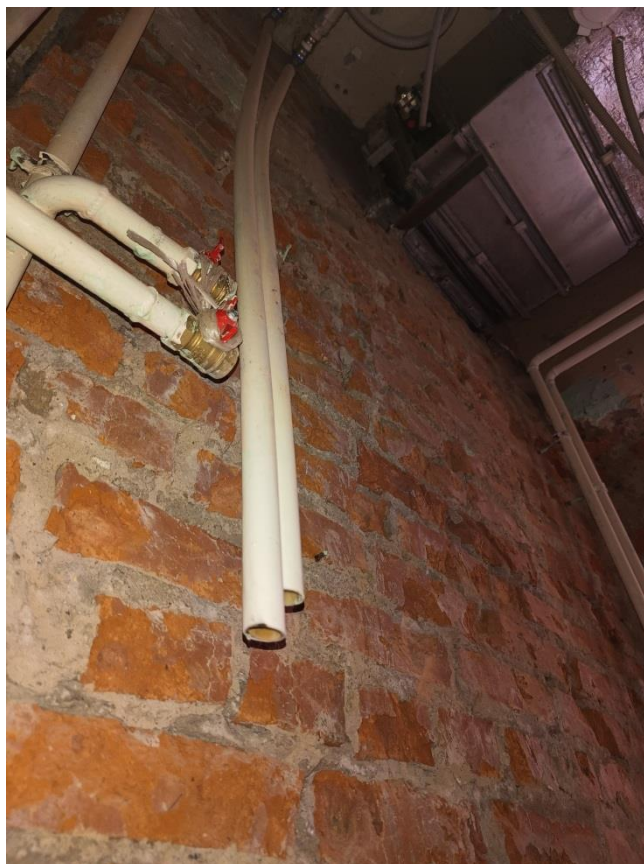
Фото №48. Трубы ТС приточной установки в коридоре изолятора
