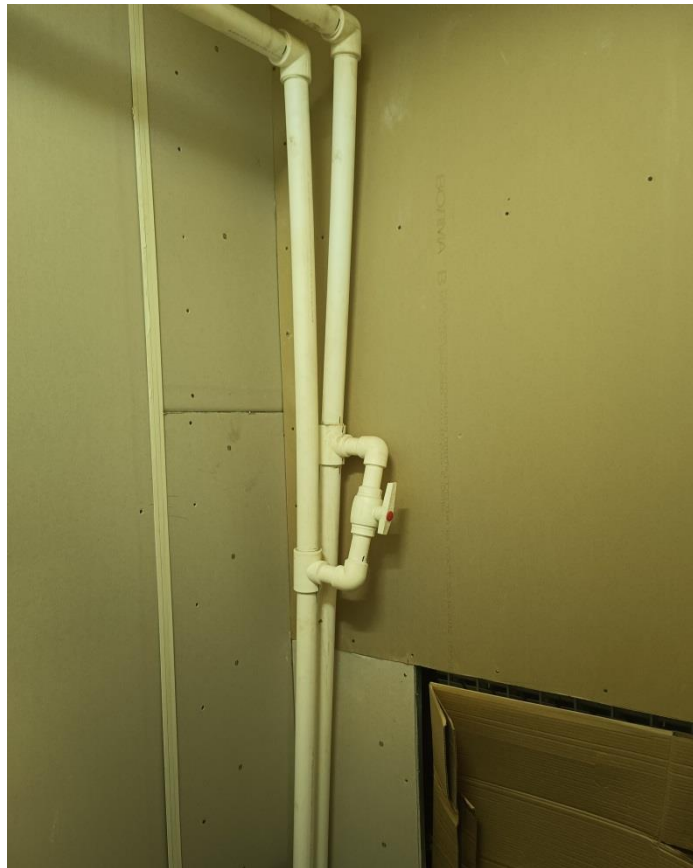
Фото №51. Трубопроводы ГВС от ИТП
