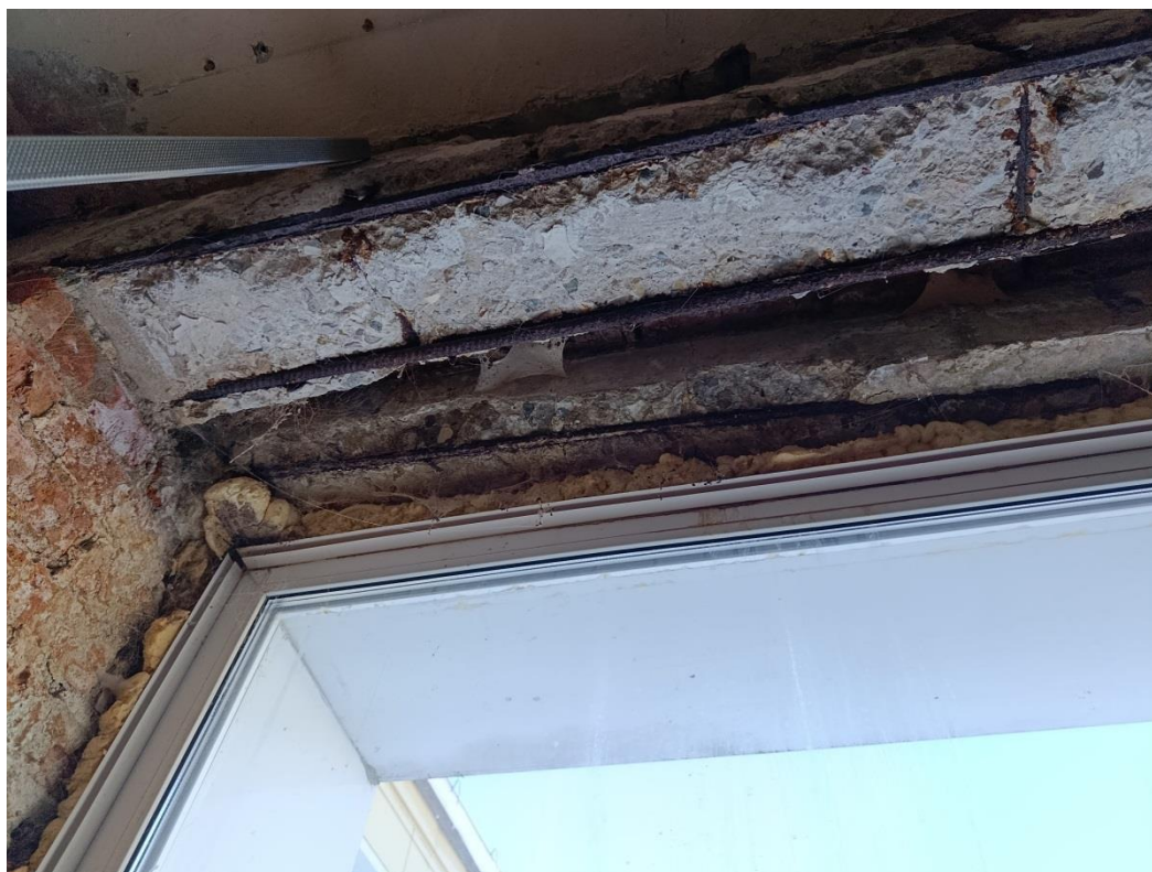
Фото 12. Фрагмент надоконных перемычек в изоляторе. Разрушение защитного слоя бетона, оголение и коррозия арматуры.
