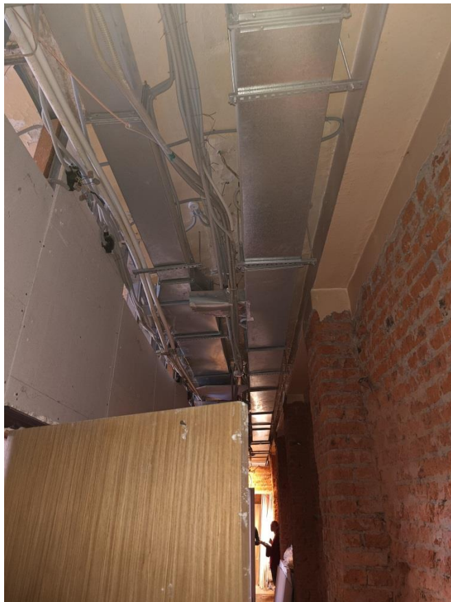
Фото №46. Воздуховоды в коридоре в блоке изолятора
