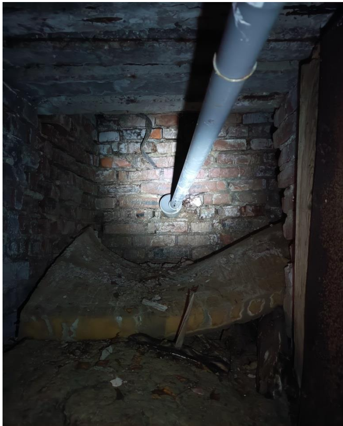
Фото №45. Выпуск канализации в подвале №1
