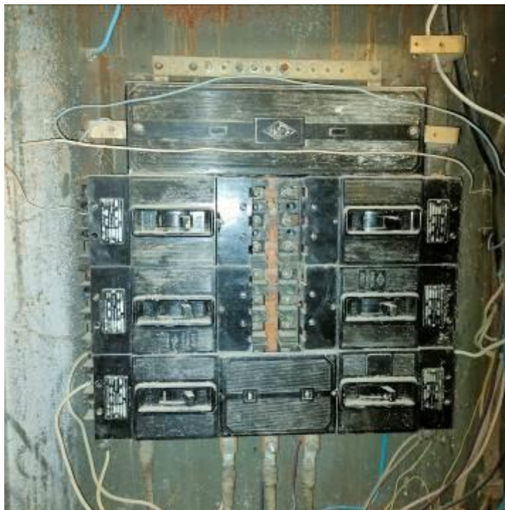
Фото №73. Распределительный щит в медпункте.
