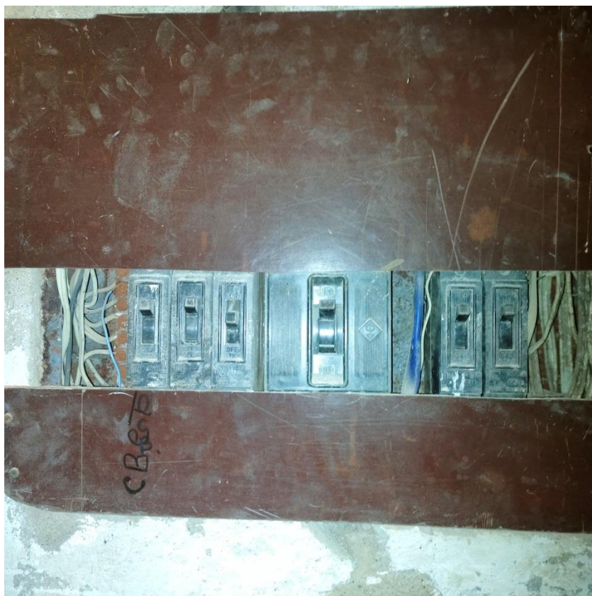
Фото №72. Распределительный щит в изоляторе
